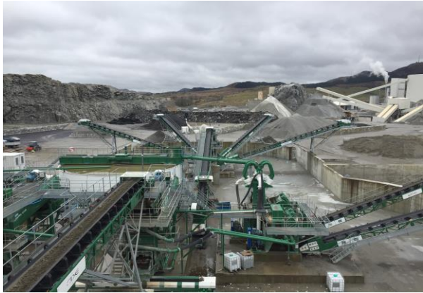
Figur 10.2 Miljøanlegget til Velde AS [eget bilde]
